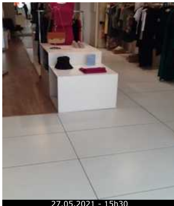
Photo 4 (Espace de vente 1 / Sol / Etat d'usage)
