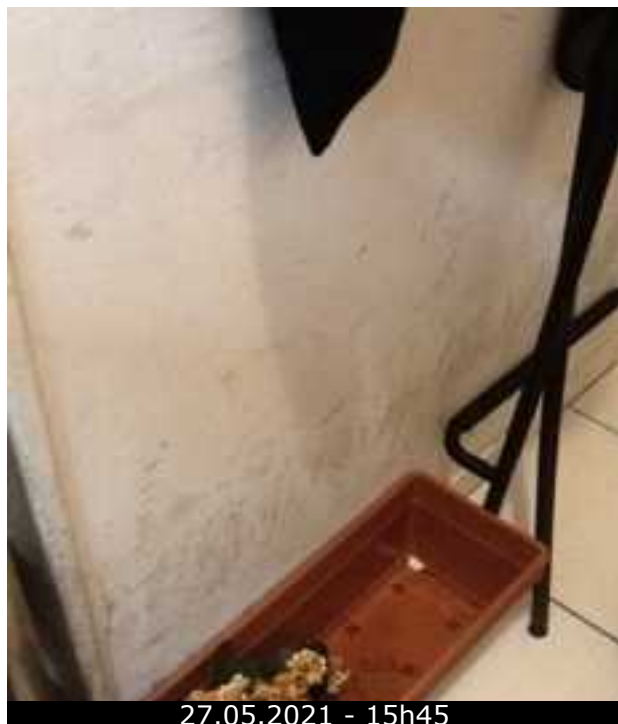
Photo 33 (Réserve 1 / Murs / Tache(s))
