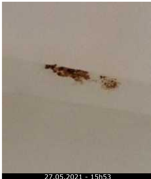
Photo 42 (Espace de vente 2 / Plafond / Etat d'usage)
