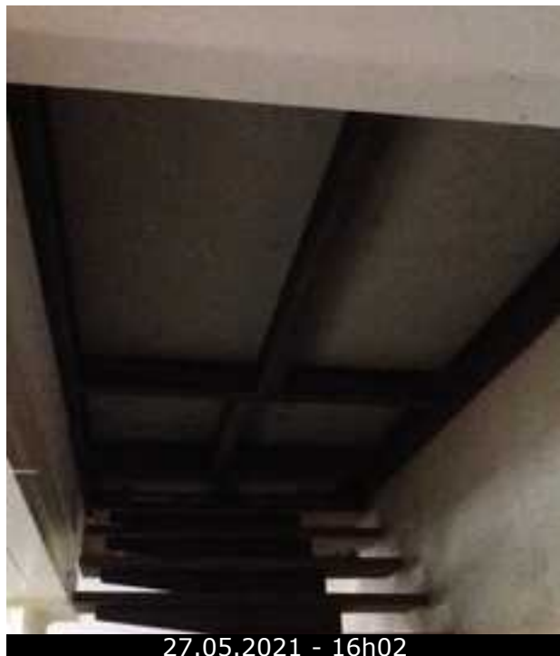
Photo 43 (Espace de vente 2 / Plafond / Etat d'usage)
