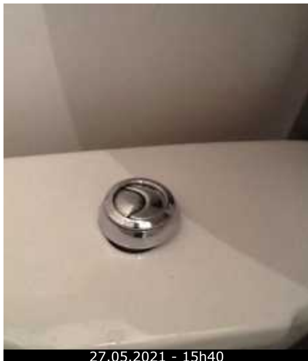
Photo 25 (WC / WC / Très usagés)
