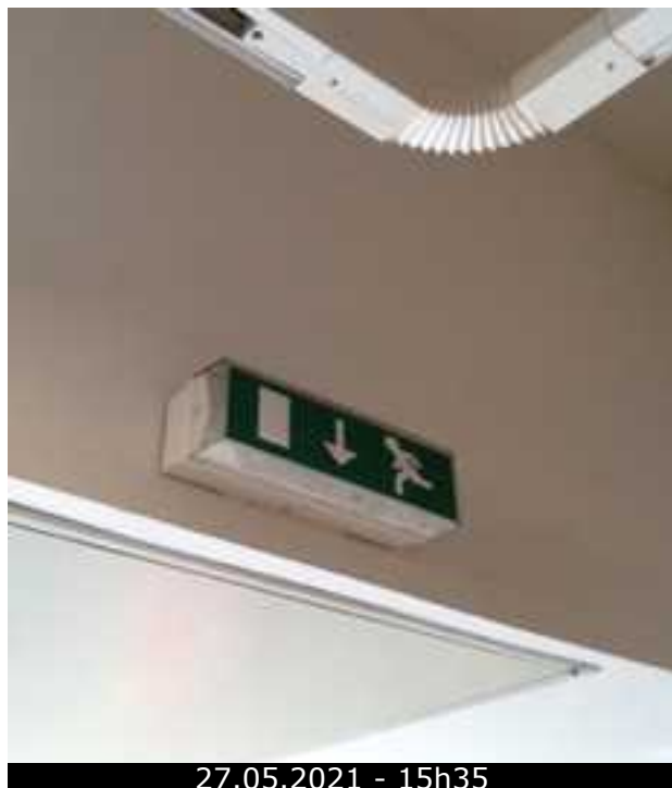
Photo 13 (Espace de vente 1 / Installation(s) technique(s))
