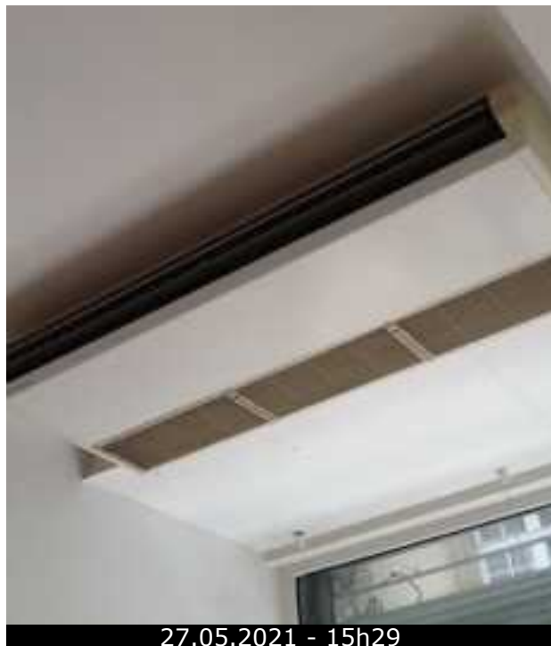
Photo 7 (Espace de vente 1 / Radiateur(s) / Bon état)
