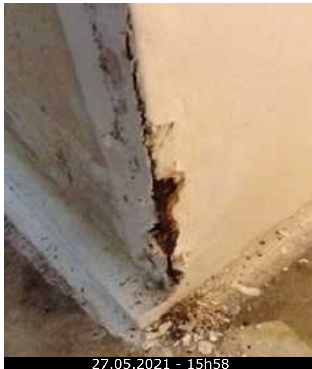
Photo 52 (Réserve 3 / Murs / Trace(s) d'humidité )
