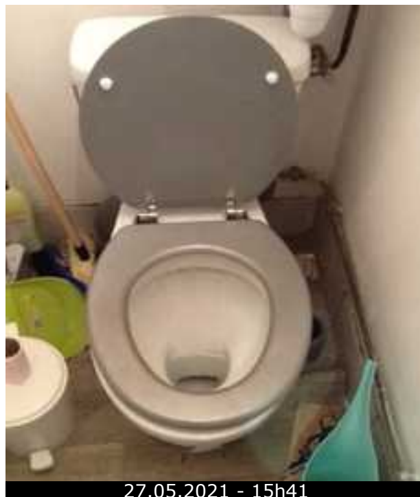
Photo 26 (WC / WC / Très usagés)
