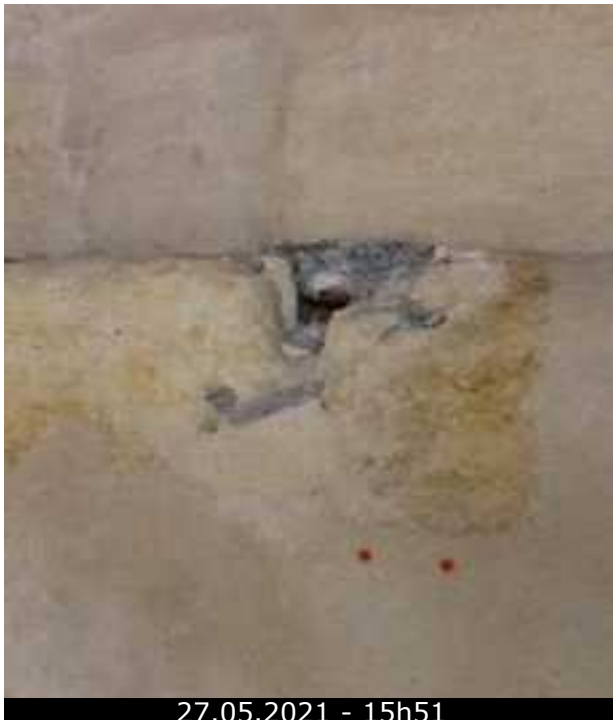
Photo 39 (Espace de vente 2 / Murs / Etat d'usage)
