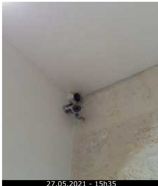
Photo 14 (Espace de vente 1 / Installation(s) technique(s))
