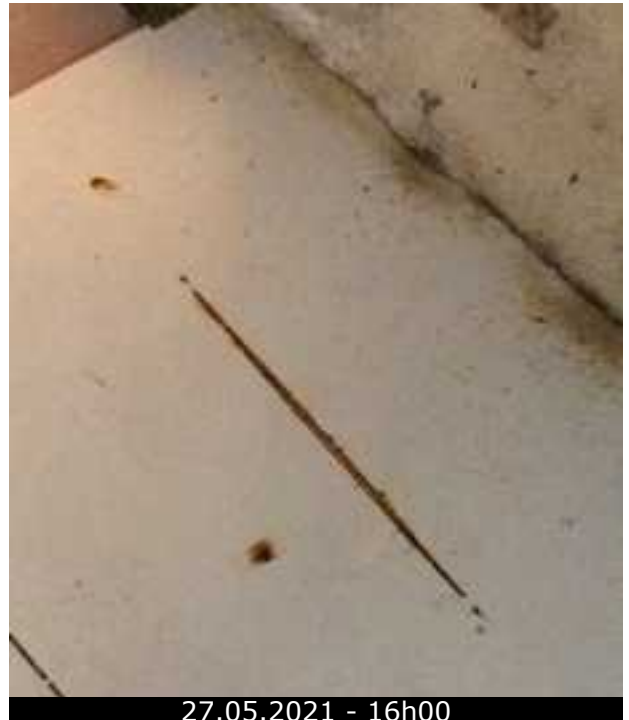
Photo 38 (Espace de vente 2 / Sol / Etat d'usage)
