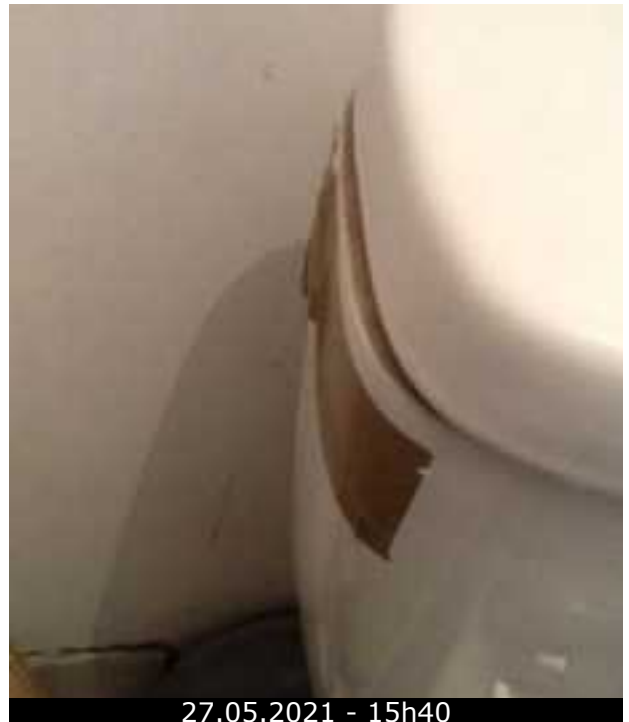
Photo 24 (WC / WC / Très usagés)
