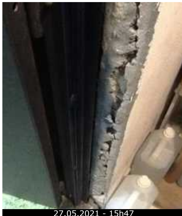
Photo 34 (Réserve 1 / Murs / Tache(s))
