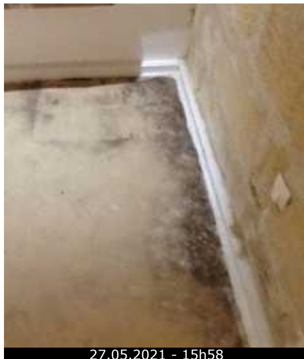
Photo 50 (Réserve 3 / Sol / Trace(s) d'humidité )
