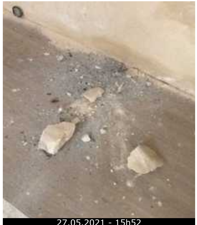
Photo 40 (Espace de vente 2 / Murs / Etat d'usage)
