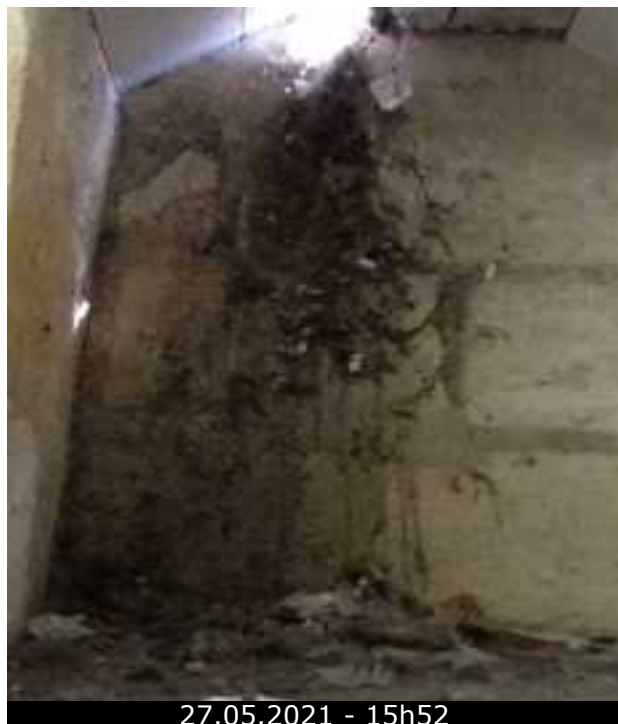
Photo 41 (Espace de vente 2 / Murs / Etat d'usage)
