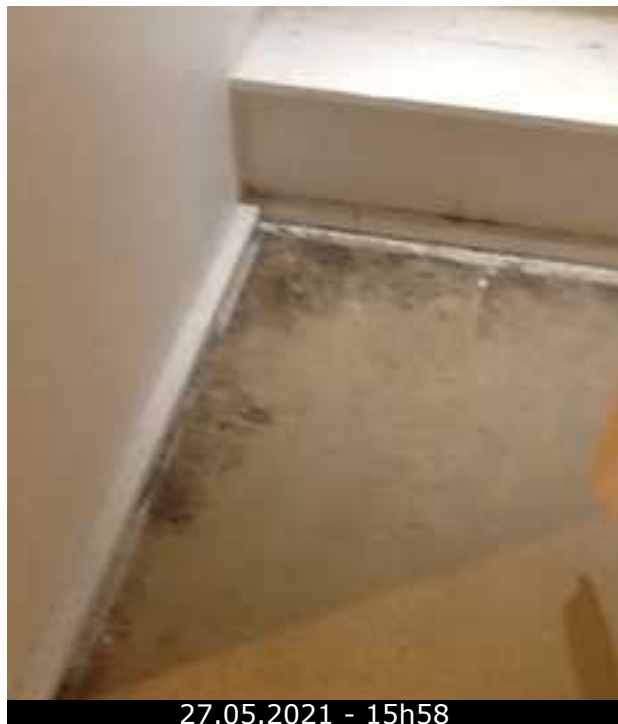
Photo 51 (Réserve 3 / Sol / Trace(s) d'humidité )
